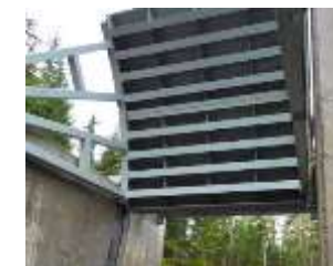
Compuertas Radiales (Tainter Gates)
