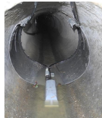
Medición en tubería parcialmente llena
